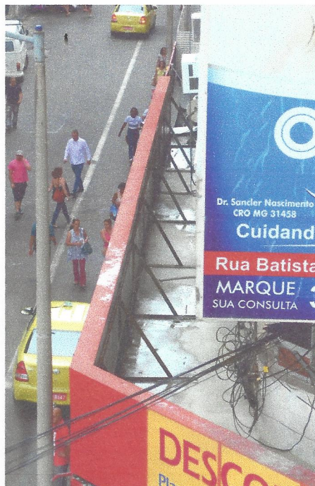
ÁGUA FICA parada em marquises, principalmente por conta de gotejamento de ar-condicionado, transformando-se em risco para a vizinhança
